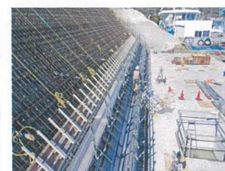
⑪上段は打設足場 下段は脱型用足場 ※型枠・足場は転用
