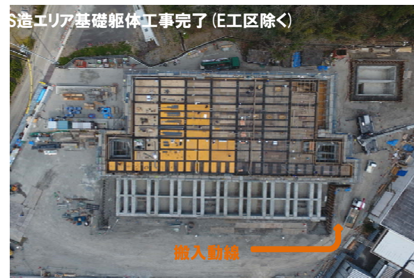
RC造エリア上部躯体工事着手後、S造エリアの基礎工事を開始。(C,D工区) E工区の未施工部分は通路として使用。
