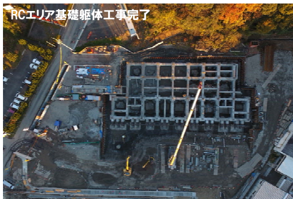
RC造エリアの基礎を先行施工。S造側の地山は残したままなので近くまでレッカーをよせることが可能。レッカー費の削減にも繋がる。
