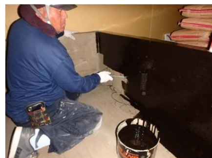
臭気：厨房塗布防水
