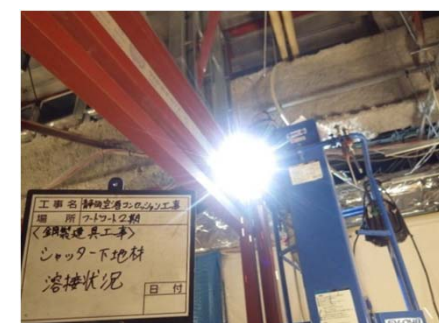
臭気：溶接作業
